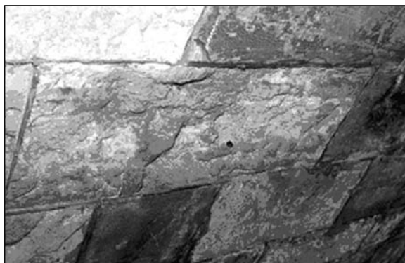
Obr. 12. Exfoliace degradovaných částí stavebního kamene místy do hloubky několika centimetrů
