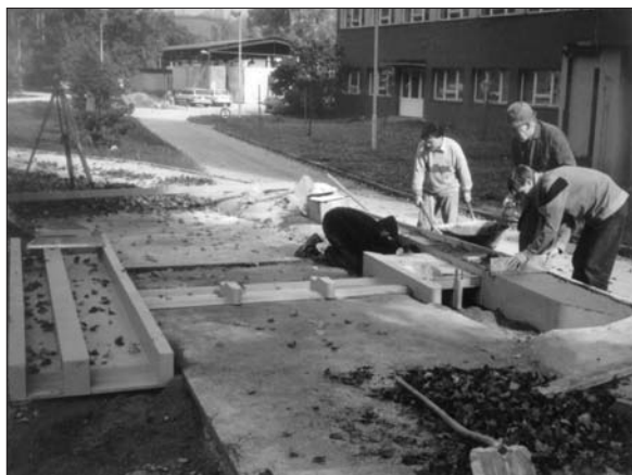
Obr. 8. Osazený model plavebního stupně Prostřední Žleb kovová (konstrukce, V. Horáček – J. Ježek)
