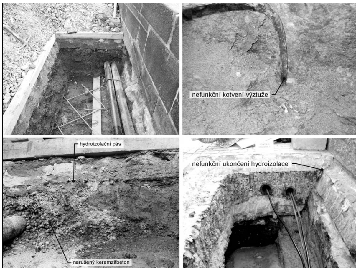
Obr. 23. Kotvení železobetonové desky v poprsní zdi (oblouk XII.), absence výztuže betonové desky (oblouk V.)
