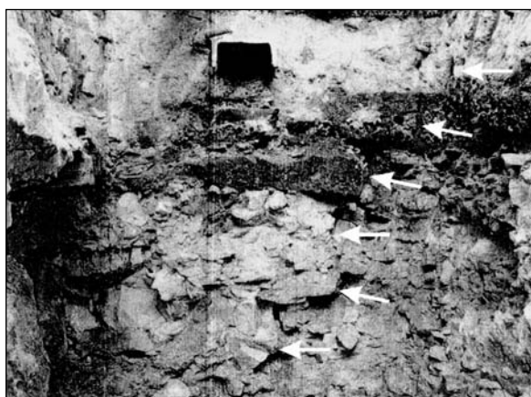
Obr. 4. Skladba mostovky, trhlina ve starém zdívu oblouku (šípky zvyrazňují průběh trhliny)
