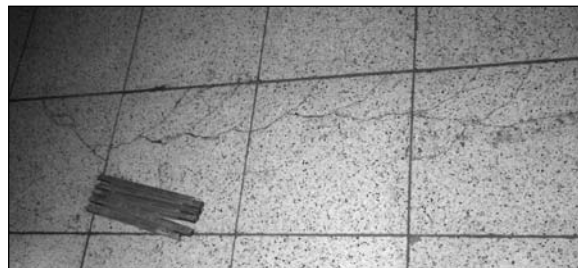
Obr. 1. Porušení podlahy trhlinou
