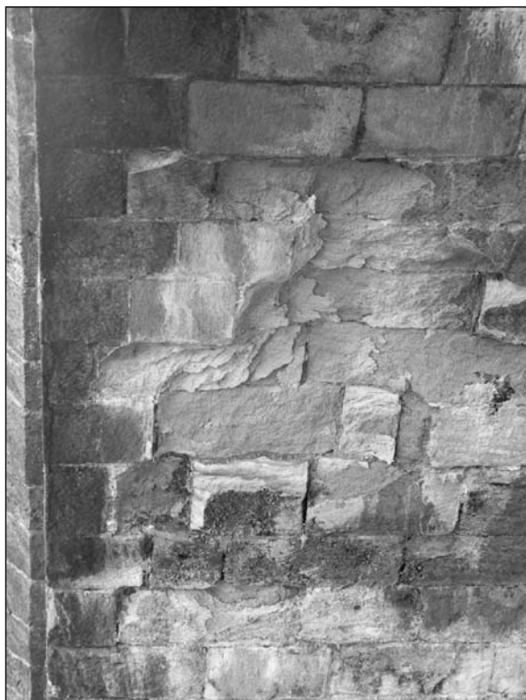
Obr. 5. Narušení a rozpad povrchových vrstev pískovcových kvádrů (oblouk XIV. nad Čertovkou)
