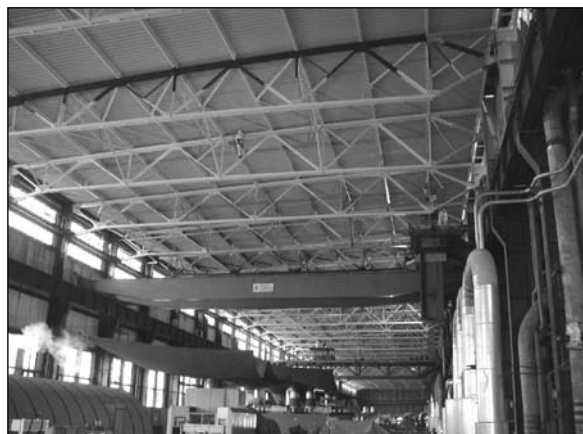
Obr. 6. Pohled do strojovny po rekonstrukci
