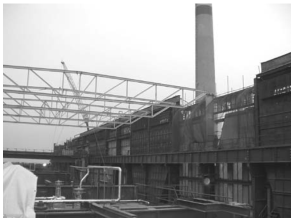
Obr. 8. Montáž vazníků, vpravo před komínem vyměněný horní dřík sloupu v řadě D
