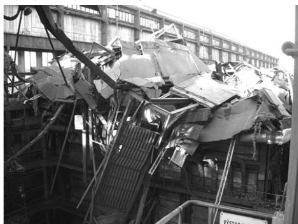
Obr. 3. Pohled do kotelny po havárii (v popředí zbytky střešní konstrukce na kotli)
