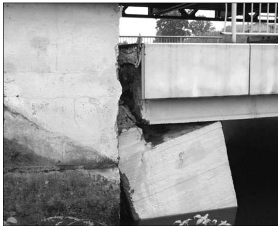
Obr. 6. Pokles a pootočení opěry
