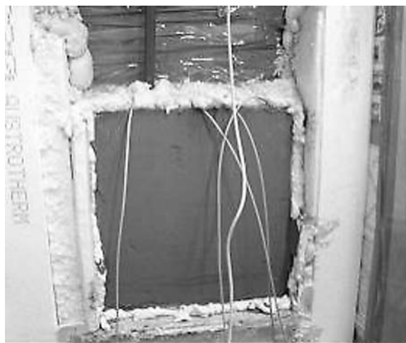
Obr. 1. Umístění senzorů v tepelně izolačním systému
