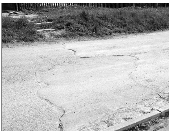
Obr. 5. Nerovnosti vozovky místní komunikace
