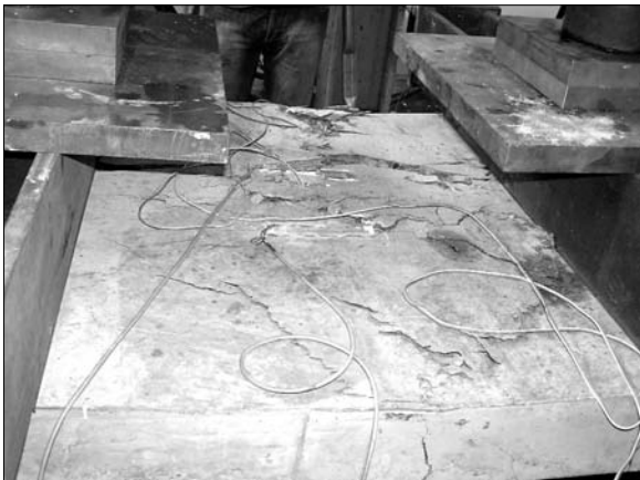
Obr. 3. Porušení betonu nosníku 1 v oblasti mezi břemeny
