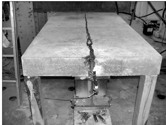
Obr. 5. Porušení nosníku 2 podél řady sřahovacích trnů
