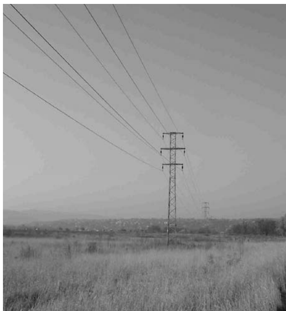
Obr. 1. Zaměřované vedení elektrického napětí v obci Lipence u Zbraslavi
