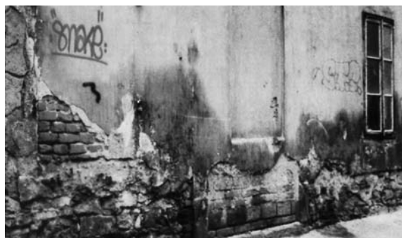
Obr. 1. Vzliňání zemní vlhkosti v obvodovém zdivu, chemická, biochemická a fyzikální degradace povrchových vrstev a zdiva
