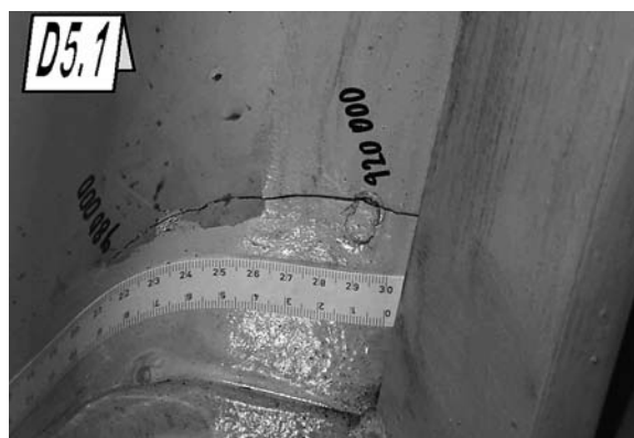
Obr. 7. Rozvoj trhliny u těles D1.1 a D5.1
