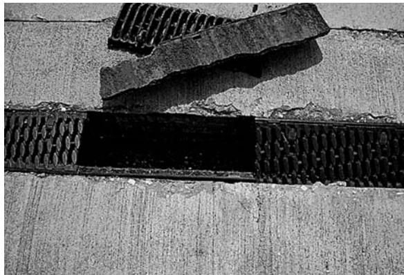
Obr. 5. Porucha odvodňovače na manipulační ploše v Plzni
