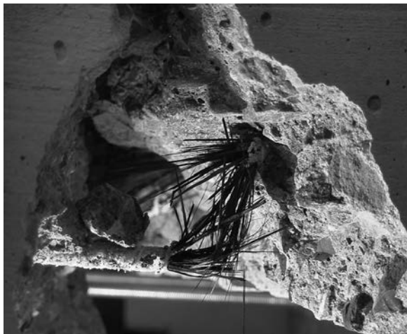
Obr. 4. Přetržení CFRP výztuže
