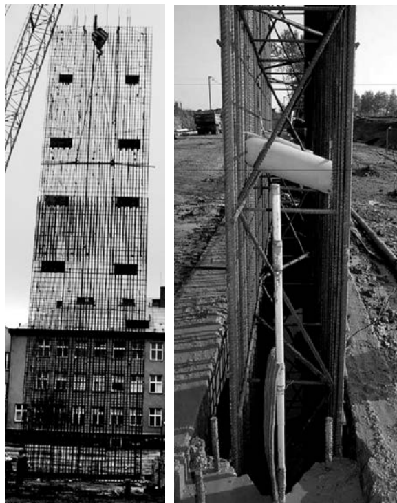
Obr. 1. Armokoš (zdroj: Zakládání staveb, a. s.) a – čelní pohled, b – boční pohled s průchozkami pro kotvu a příčnou výztuž
