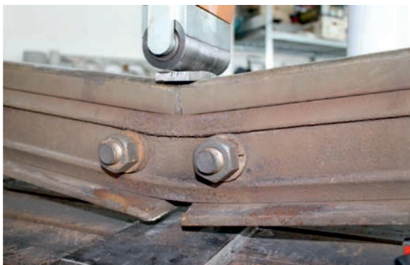
Obr. 7. Deformovaná kolejnice a spojka po experimentu
