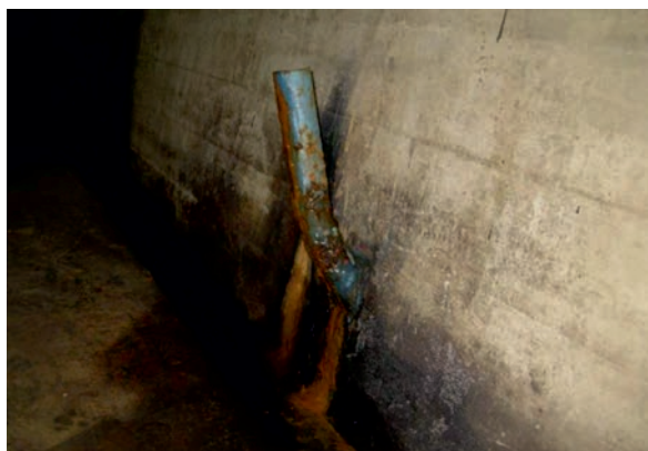
Obr. 4. Zkorodované zhlaví vrtu
