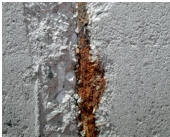
Obr. 3. Odprýskání krycích vrstev betonu a koroze výztuže
