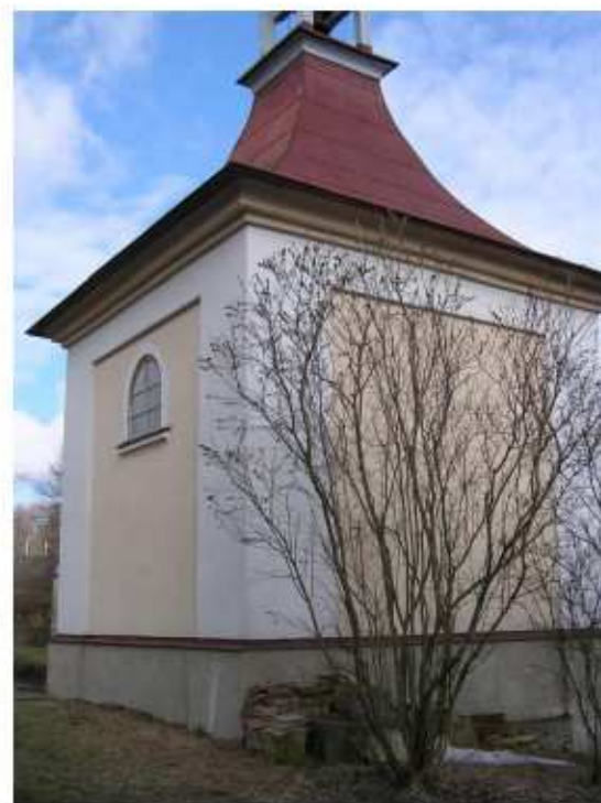
Chybí pravý roh snímku a část římsy.
