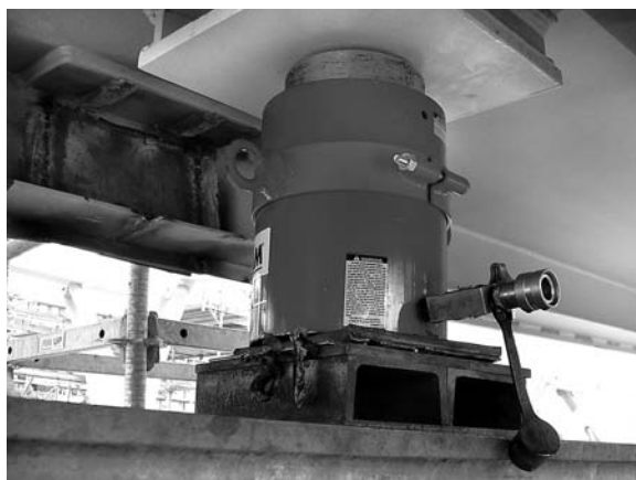
Obr. 4. Detail lisu nosnosti 150 t pod průvlakem
