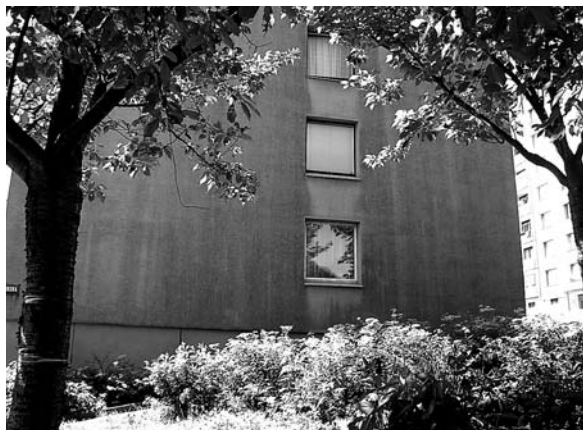
Obr. 1. Příklad dodatečně zatepleného objektu napadeného řasami
