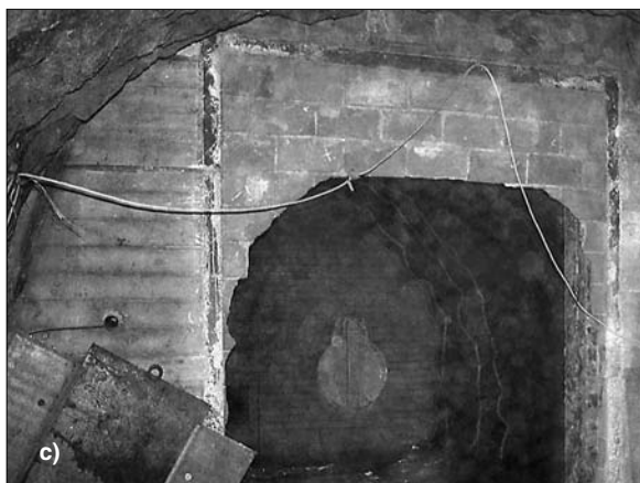
Obr. 7. Zděné příčky v přehradní konstrukci a – část tl. 65 mm se zvýrazněnými trhlinami, b – část tl. 290 mm se zvýrazněnými trhlinami, c – havarovaná zeď tl. 65 mm
