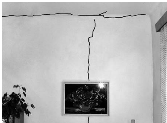
Obr. 5. Trhliny ve stropním fabionu a svislá trhlina v obvodovém nosném zdivu domu (pohled zevnitř)
