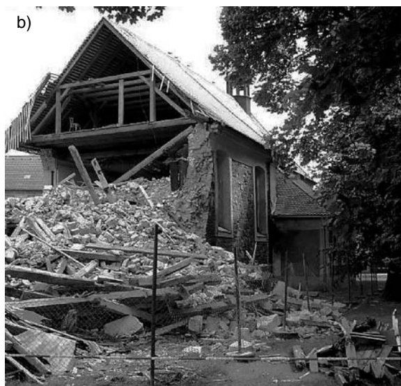
Obr. 1. Pohled na západní část kostela [4] a – před pádem věže, b – po jejím pádu
