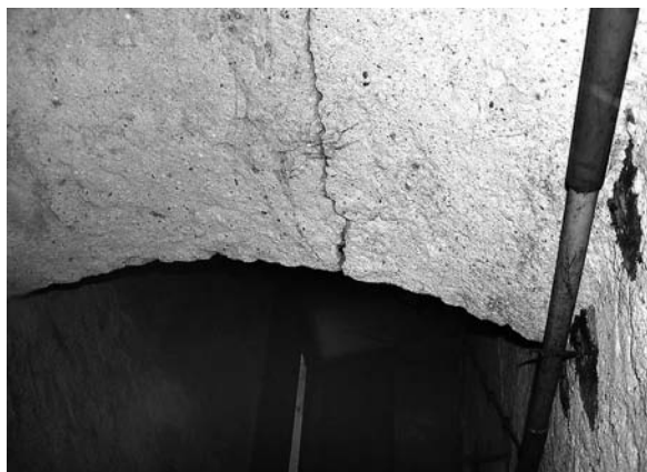
Obr. 3. Příčné trhliny ve stropní klenbě nad sklepním schodištěm
