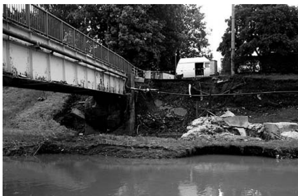
Obr. 1. Nátrž v okolí břehové opěry lávky pro chodce přes Jičínku (2009)
