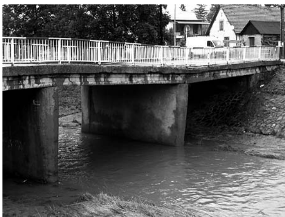
Obr. 2. Podemletý středový pilíř a prolomení mostovky silničního mostu přes Jičínku (2009)
